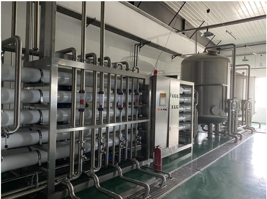
照片 1-7 生产车间 4
